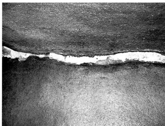
図 2 南下 A 号古墳における漆喰状物質の産状 Fig. 2 Plaster at Minamishimo-A Tomb
