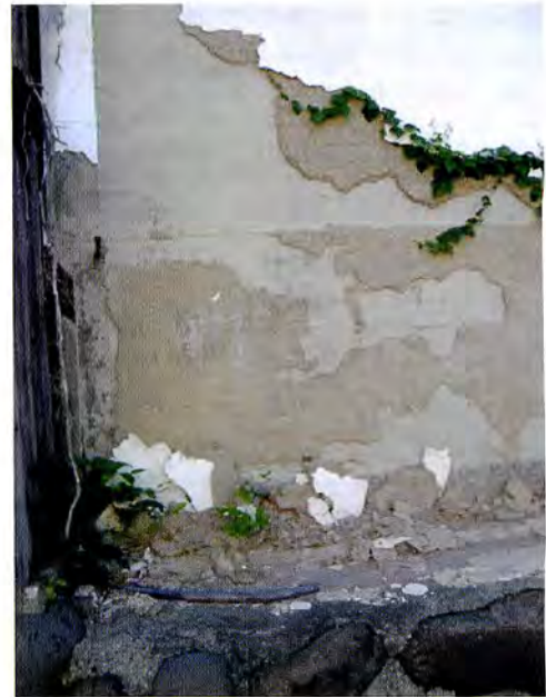
図4 漆喰層の剥落によって露出した中塗り土層
