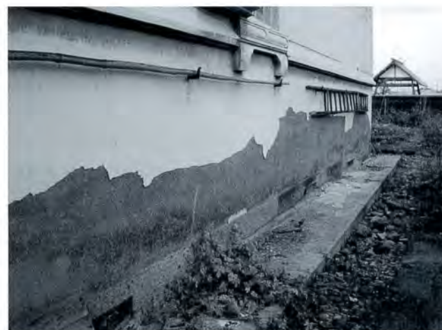
図2 漆喰壁土蔵南面の漆喰層の剥落喰層の剥落
