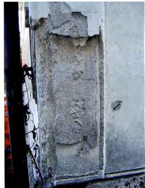
図5 漆喰層の剥落によって露出した砂漆喰層
