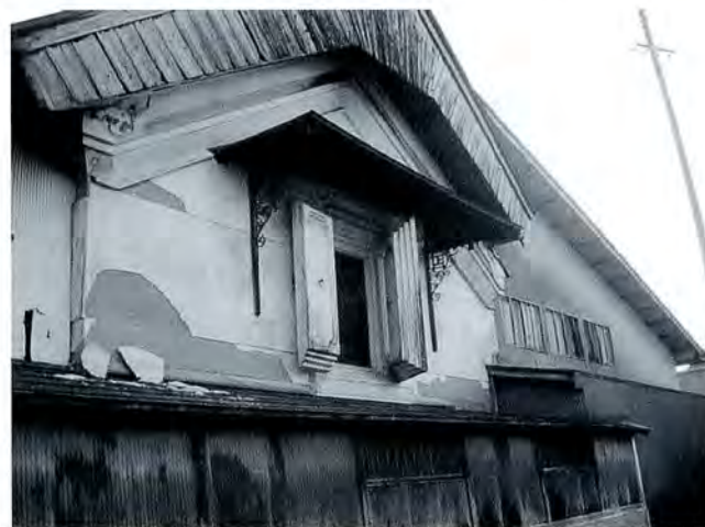
図1 山形県河北町の漆喰壁土蔵にみられる漆喰壁土蔵北面の漆喰層の剥落
