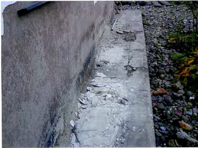
図3 地面に剥落した漆喰層
