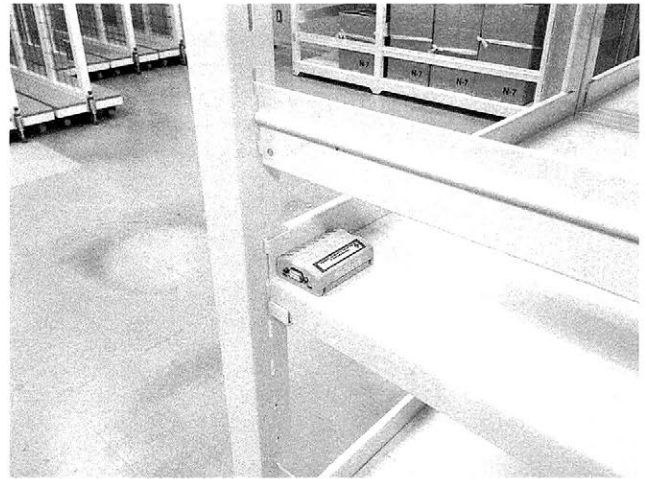
写真5 収蔵庫に設置したデータロガー Photo 5 Data logger that was set in storage.
